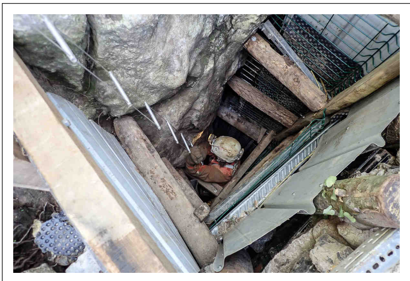
◁L'entrée du Plan C. Suite aux crues, l'é-tayage du puits d'entrée à été renforcé avec des piquets de clôture en accacia.
